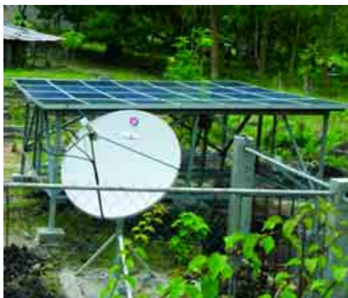
Satellitenempfangsanlage mit Solarstromversorgung
