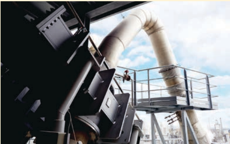
Abb. 3 Oben: Das Kalkwanderbett verlässt den Reaktor, anschließend werden Asche und Schadstoffe ausgesiebt. Unten: Rohgasrohre mit Sicherheitsschiebern.
