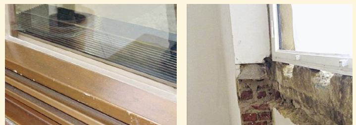
Abb. 29 Denkmalverträgliche Zuluftführung unter dem Wetterschenkel bei dezentraler, fassadenintegrierter Klimatechnik (links: Deutsches Historisches Museum Berlin, rechts: Kaiser Wilhelm Museum, Krefeld, Fensternische im Bauzustand mit Zuluftöffnungen) Quelle: Volker Huckemann
